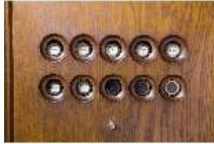
Neusch.II, Vorzimmer, R. 3, Elektr. Klingelanlage, DI002160, BSV
