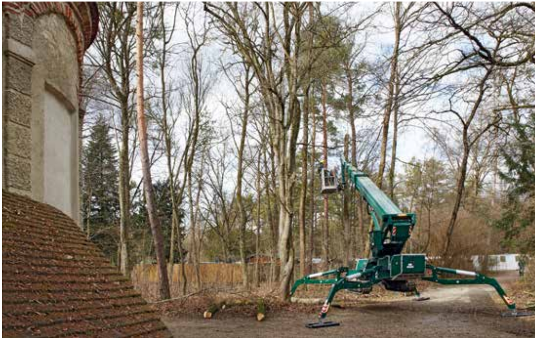
Baumpflegearbeiten neben der Magdalenenklause im Schlosspark Nymphenburg. Der kleine, kettengetriebene Hubsteiger mit Auslegern hat eine maximale Arbeitshöhe von 31 Metern, 2021
